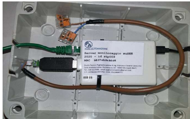
8 Sistema Monitoraggio Energetico - Server
